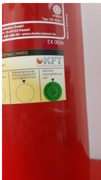
Prüfplakette an einem Feuerlöscher
