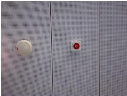
Rauchmelder und Anzeigeelement an der Decke
