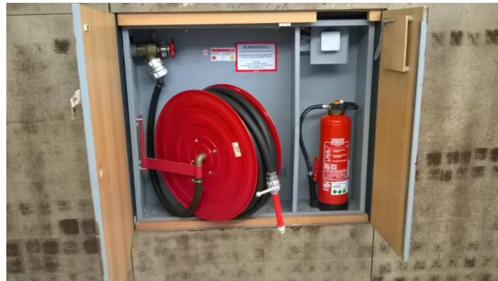
Wandhydrant und Feuerlöscher
